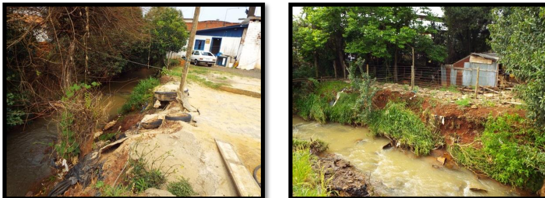
Figura 61 e 62 – Trecho sujeito à risco geotécnico.
