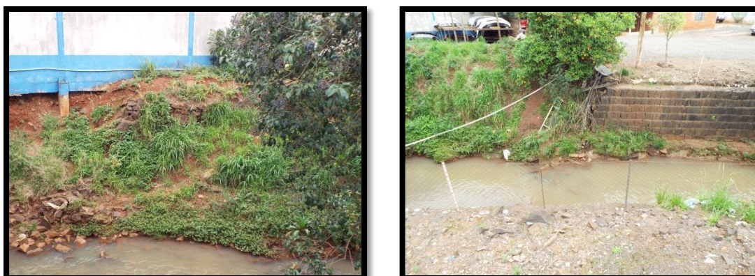
Figura 34 e 35 – Trecho sujeito a risco geotécnico.
