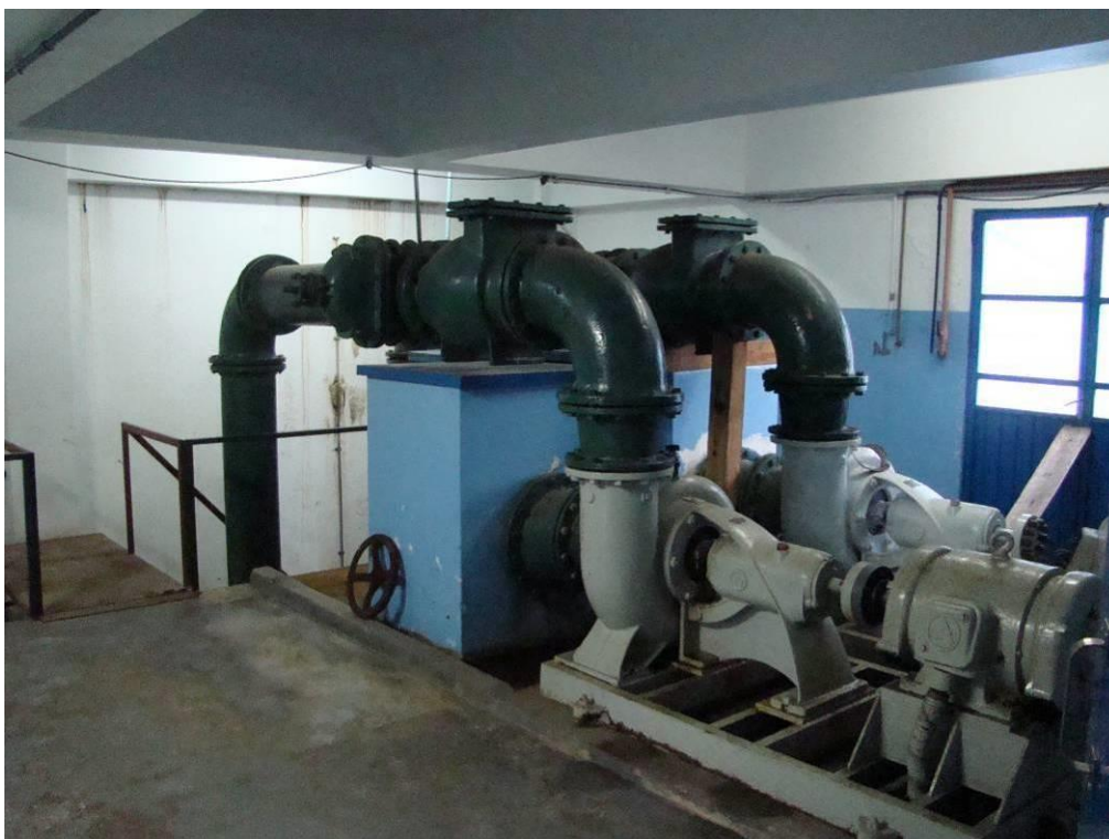
Figura 31: Sistema de bombas
