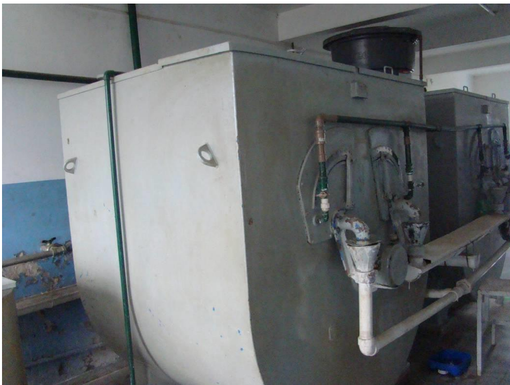
Figura 32: Dosador de produtos químicos
