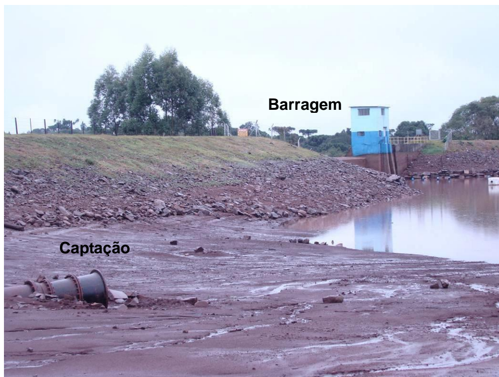
Figura 17: Barragem do Lajeado Tigre (Guatambú) com o nível abaixo da captação apesar da precipitação de 95mm em 24horas. (Foto de 22/04/10)
