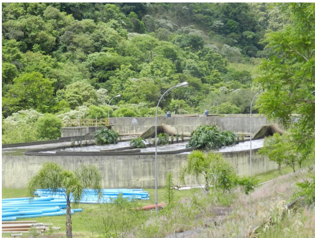
Figura 54: Chegada do esgoto na ETE de Chapecó
