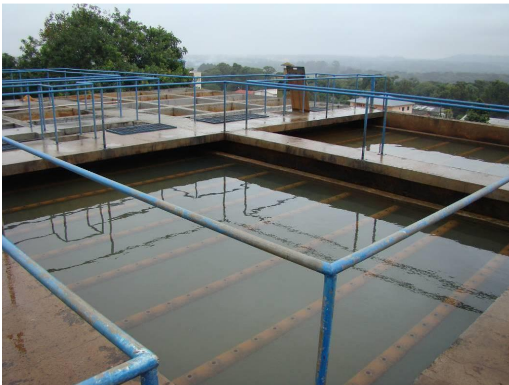
Figura 34: Sistema de filtração
